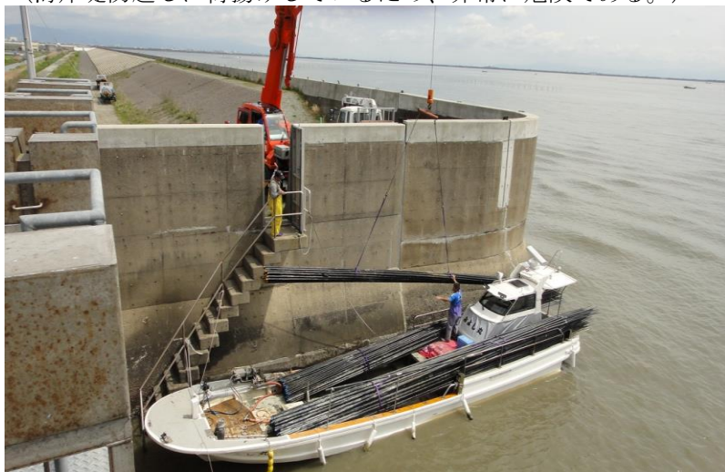
⑱福富新樋門写真【海苔養殖用支柱荷揚げ場所】 （海岸堤防越しに荷揚げしているため、非常に危険である。）
