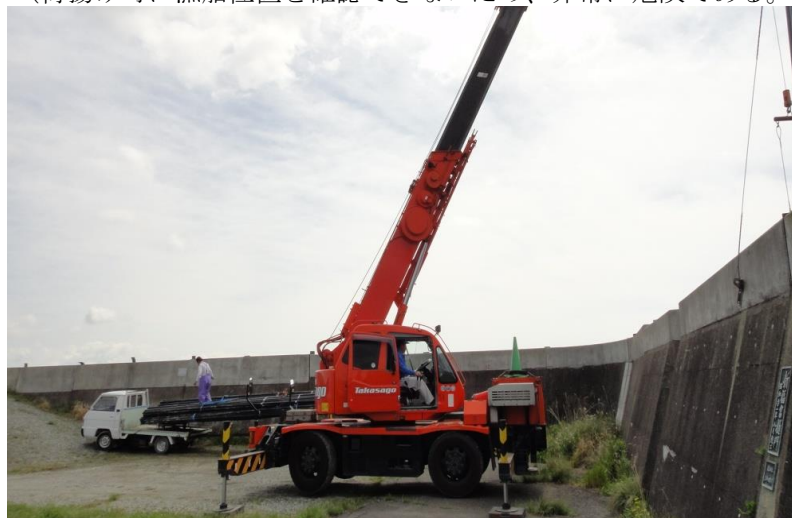
⑲福富新樋門における荷揚げ用クレーン設置場所 （荷揚げ時に漁船位置を確認できないため、非常に危険である。）
