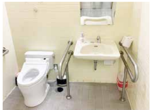
●車いす用トイレも自動化
