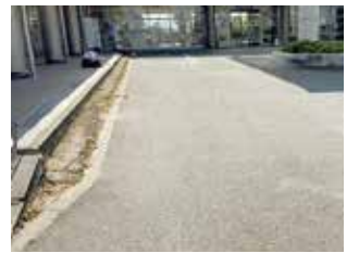
●外は地盤沈下で段差が
