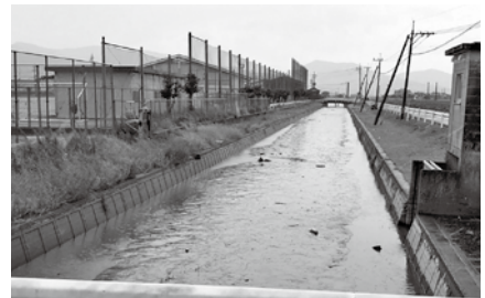
●事前排水により落水された地沈水路
