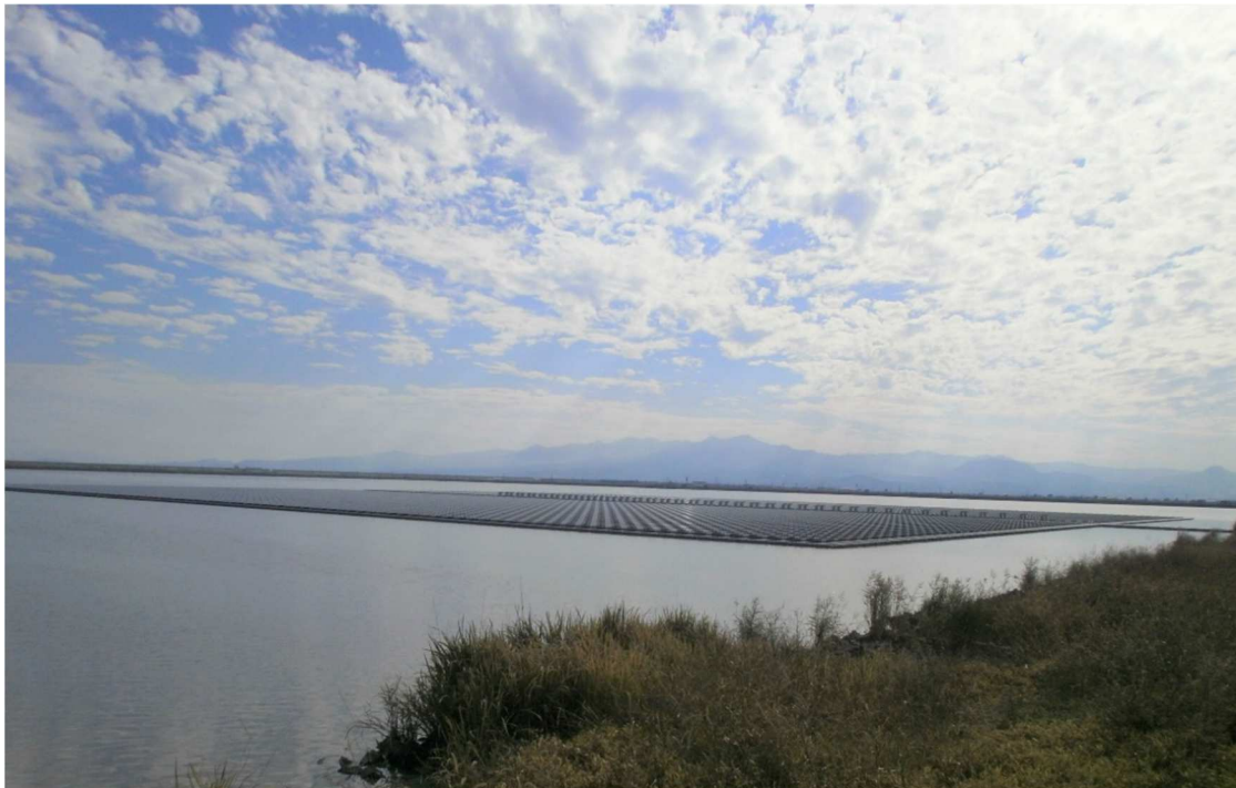
水上太陽光発電施設(有明貯水池)
