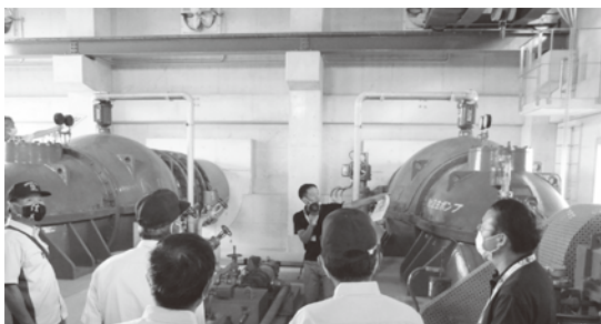
●新明排水機場ポンプ施設
