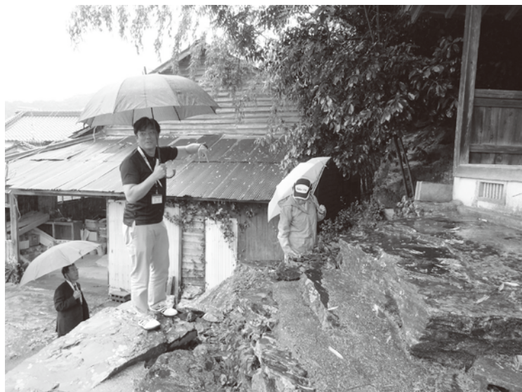
●川津地区の急傾斜地
