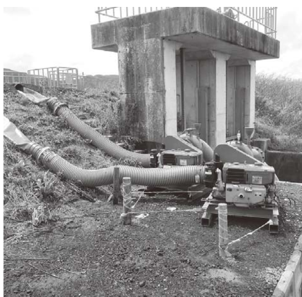
●地沈水路に設置された仮設ポンプ
